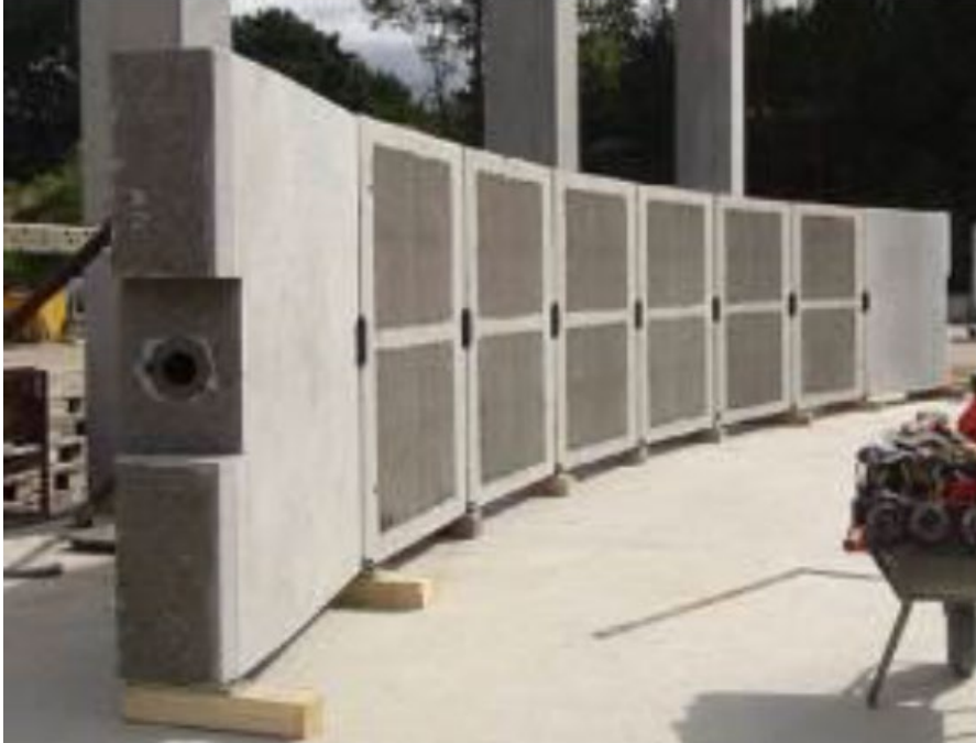
Figur 6: Elementer står på siden og er klar til at få støbt samlinger og blive spændt op.
