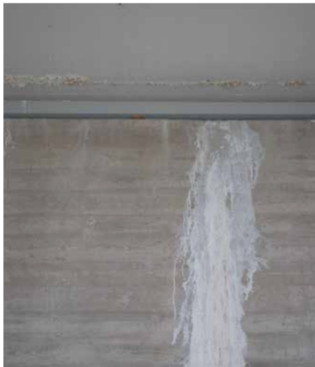
Afsprængt, plastikmalet beton og rusten armering. Foto: Christina Särs Vernersen
