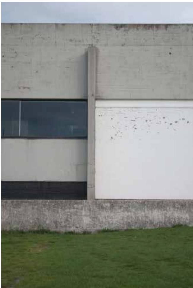
Udsnit af den nordvendte facade; her ses et overmalet vindue, afskallende maling samt en plastikmalet betonsektion. Foto: Christina Sårs Vernersen
