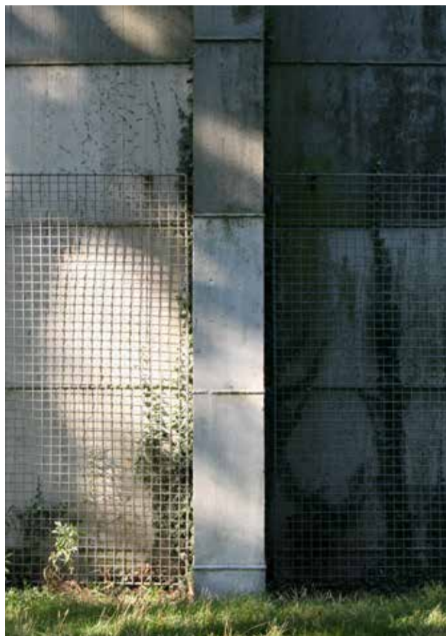
Vandtårnets møde med jorden. På begge sider af søjlen ses de nyere galvaniserede stålgitre, der er monteret på facaden. Foto: Laust Øby
