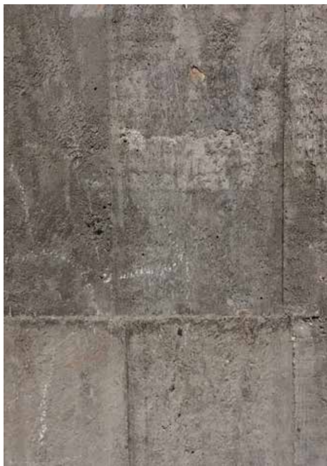
Strukturen fra bræddeforskallingen anes under lag af grå maling. Foto: Laust Øby
