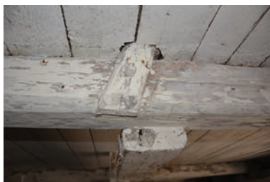
Påbladede skråbånd styrker bjælkernes spænd i staldlængen. Alle flader med undtagelse af gulvet er hvidkalkede i stalden. Kalk er ætsende og har derved hæmmet bakterievækst.
