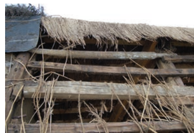
Huset er præget af ressourcensparelser. Her har en knækket åre fundet anvendelse som lægte. Billedet er taget i forbindelse med tagomlægningen i 2012. Foto Frank Svendsen.
