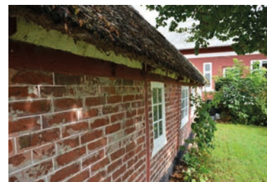
Tagets udhæng er ca. 40 cm, og tagfoden er lukket med en sugffjæl. Ved soklen ligger pigsten.
