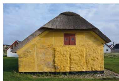
Fiskerhusets vestgavl. Tavlene i den udsatte vestgavl er udmuret med marksten. Senere er de øvrige tavl blevet omsat i tegl.
