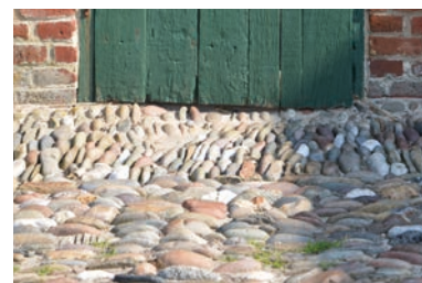
Gårdspladsens sirlige strandstensbelægning. Stenene vender den korte side mod bygningerne, så nedbør hurtigt ledes bort.
