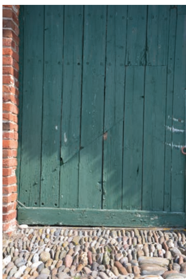
Porten på Abelines Gård er sikkert blevet repareret.
