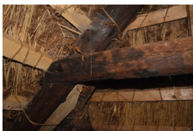
Røgsværtet tømmer i husets østlige del. Da huset blev bygget i Vester Agger i 1749, havde det formodentlig ikke en skorsten, men blot et lyrehul, hvorved røgen sværtede og imprægnerede tagværket.
