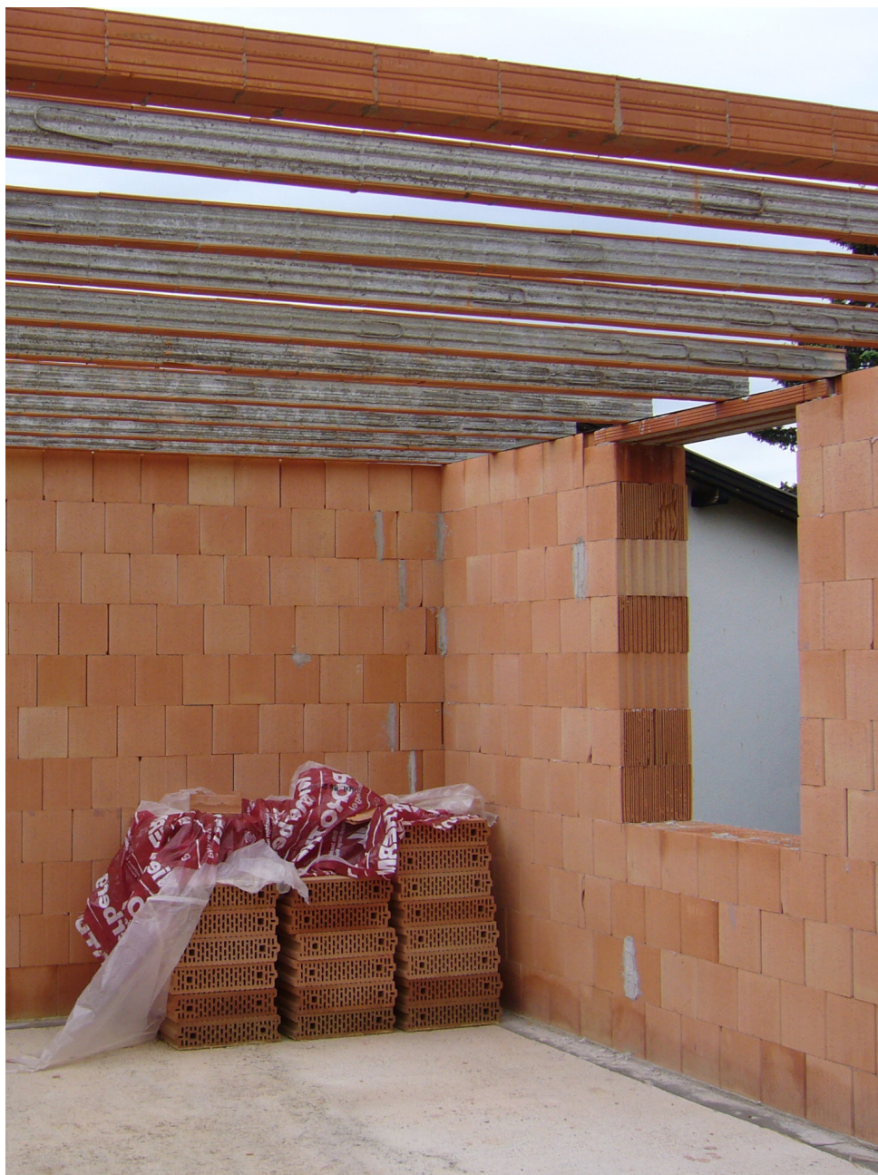
Byggeplads hvor teglblokke bruges til opbygning af ydervægge og indervægge. Præfabrikerede bjælker i loft til udlægning af dækelementer i tegl Præfabrikeret overligger ved vinduesåbning. Foto Nini Leimand
