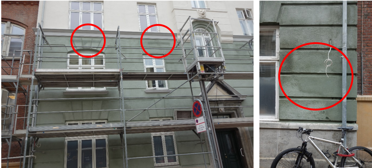
Skjolder efter nyere pudsreparationer, t.v. efter indmurede jern. T.h. alm. pudsreparation
