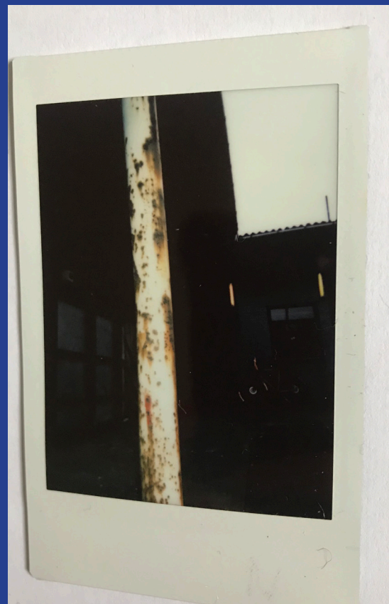
Nærfoto af delvis rusten hvidt rør.
