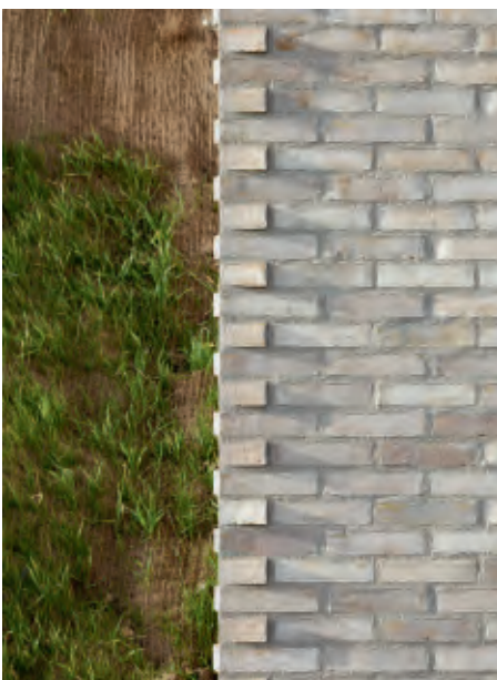
Stationens sydøstvendte hjørne er ikke 90°, hvorfor de rektangulære sten stikker ud og danner et mønster. Murværket er opmuret i et halvstensløberforbandt.
