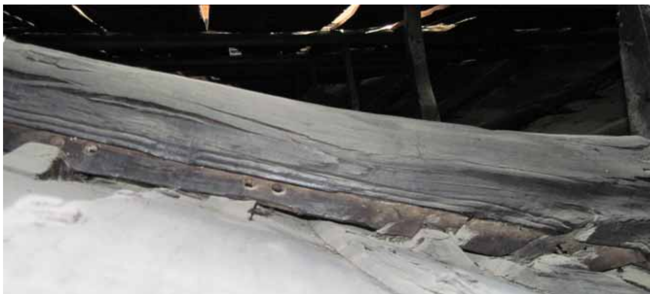
Fig. 6.15. Den underste del af bundstokken og den øverste del af klampen er kollapsede i det udstillede skib, så bordet og bundstokken står tættere sammen, end de oprindeligt har gjort. Det fremgår af fotoet, at bundstokken ikke ville støde mod bordet, hvis klamperne ikke var kollapsede. Dette kollaps er der ikke kompenseret for i hverken Glendes, Johannessens eller Lundins tegninger af skibet. Foto forfatteren.
