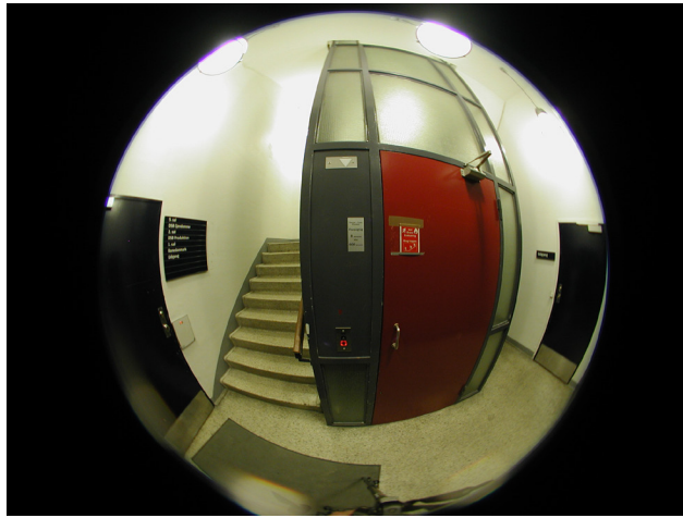
III. 5.7.9 Trappeforbindelsens jævnt spredte belysning
