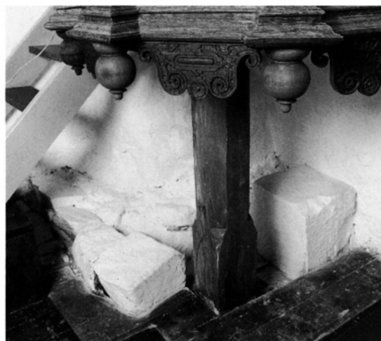
Fig. 27. Den nederste del af prædikestolen, fra 1613, samt murværk og enkelte kvadre muligvis fra †muret prædikestol og/eller †sidealter (s. 3127, 3134 og 3141). NE fot. 1985. - Foot of the pulpit from 1613, together with masonry and one or two ashblars possibly from a †stone-built pulpit and/ or †side-altar.
