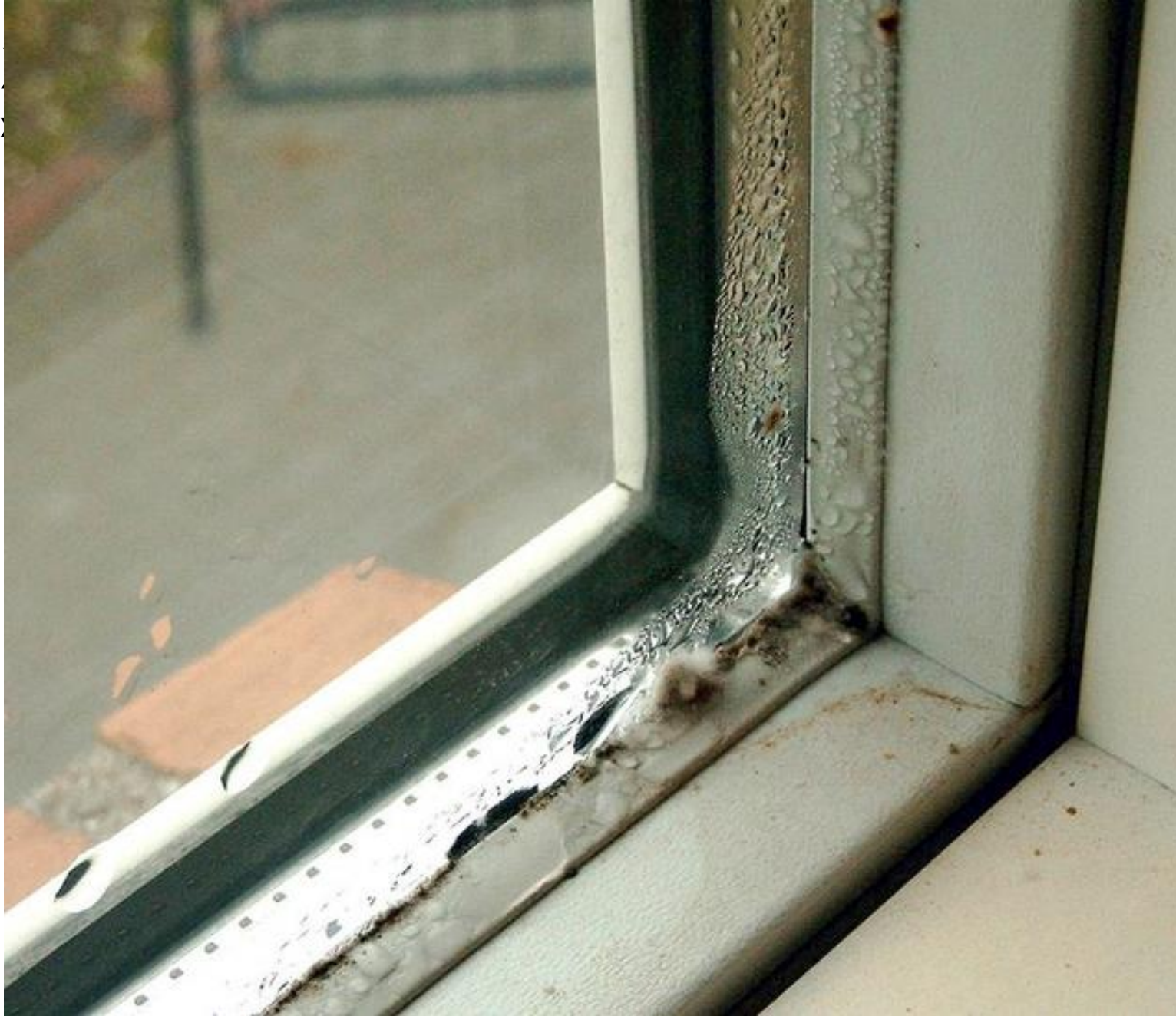
nutidens vinduer – termoruder, damptætte fuger + false = indeklimaproblemer + allergi
