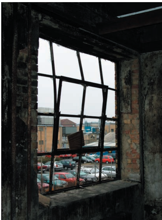
Ødelagt smedejernsvindue - rummet er udbrændt
