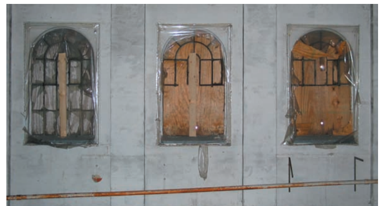
De to vinduer til højre er ødelagte
