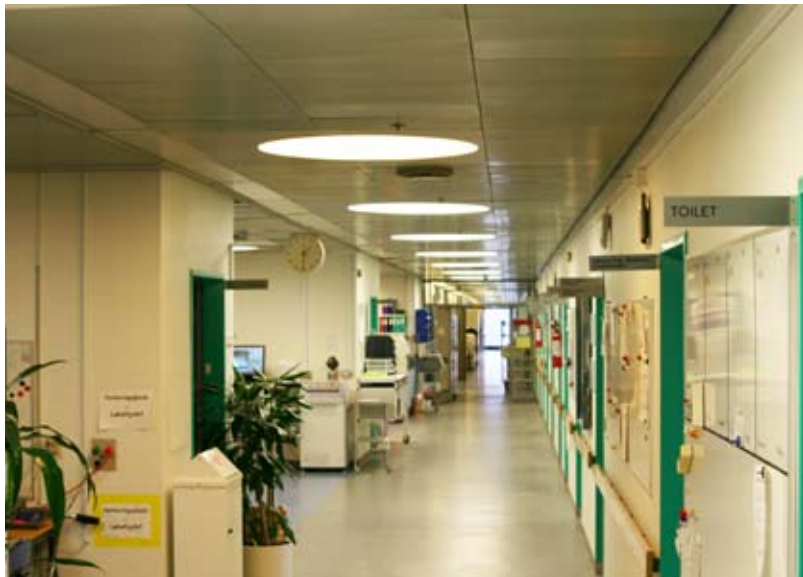
Renoveret gang på Rigshospitalet med de store specialdesignede lysmaskiner i loftet.
